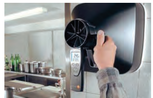
Мониторинг объемного расхода на вытяжном вентиляторе
